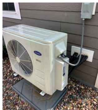
Groupe de Clim ou pompe à chaleur de maison
